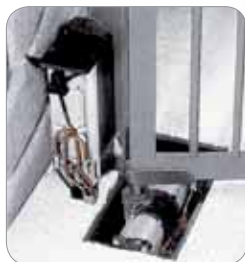
Instalace pohonu a hydraulické jednotky - vnitřní pohled
