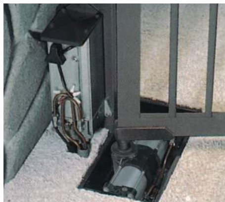
Instalovaný hydraulický blok a hydraulická jednotka
