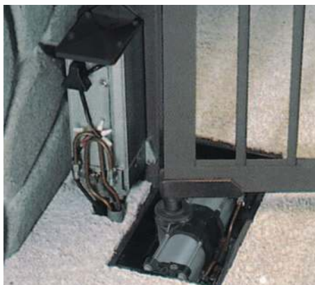
Instalovaný hydraulický blok a hydraulická jednotka
